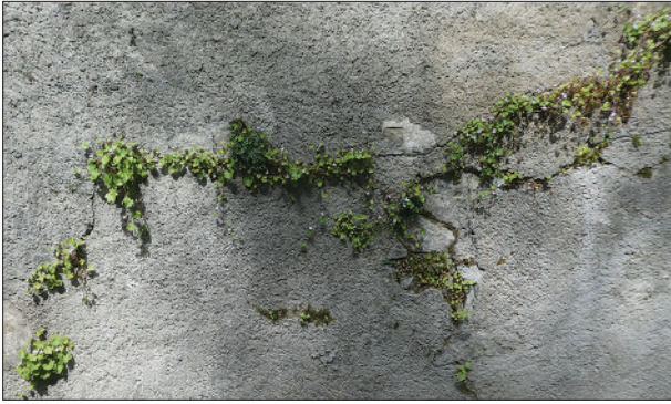
Figure 77: La ruine de Rome ( Cymbalaria muralis ) colonise la moindre fissure de mur à sa disposition.
